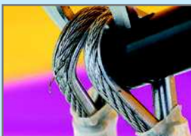
Kauschen und Seile müssen auf Beschädigungen überprüft werden und in diesem Fall ausgetauscht werden.
